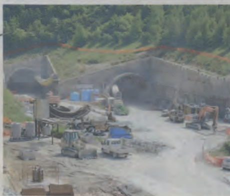
IL CANTIERE Ieri è stato abbattuto l'ultimo diaframma della galleria situata nel comune marchigiano di Muccia
